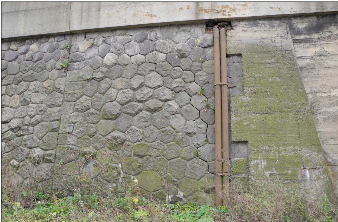
Obr. 42: Svislá pracovní spára v kyklopském zdivu a navazujících žb. konstrukcích, trhlina u napojení pod prostupy
