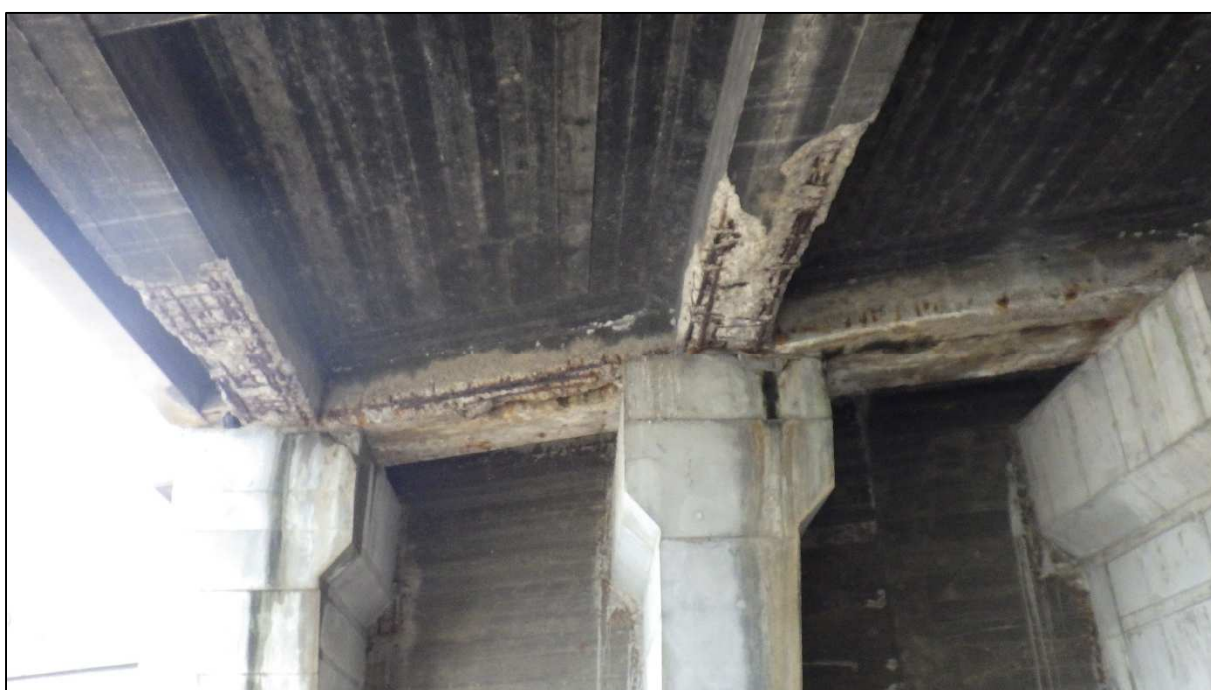
Obr. 4: Pohled na stav koroze příčného trámu u provizorně podepřeného kloubu rámové konstrukce výrazná koroze obnažené výztuže, chybějící krycí vrstvy i na navazujících podélných trámech
