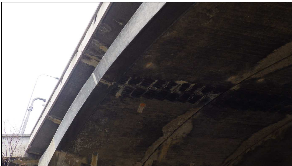
Obr. 9: Pohled zespodu na vrcholový kloub prvního mostního oblouku ve směru od Holešovic, z fotografie patrné zatékání vody spárami, viditelné prefabrikované bločky
