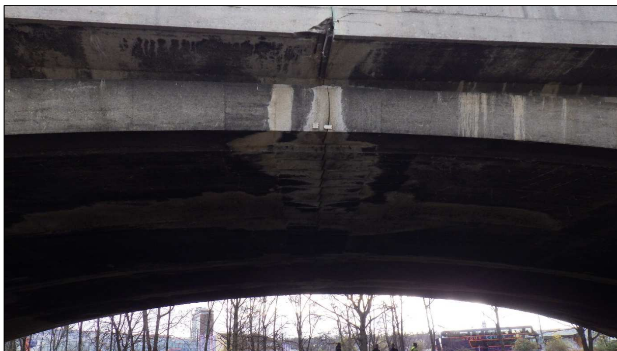
Obr. 25: Jižní pohled na vrchol nejdelšího oblouku mimo koryto – část Libeň, ve vrcholu osazené měření, viditelné poškození římsy v místě kloubu, sevřeného nahoře
