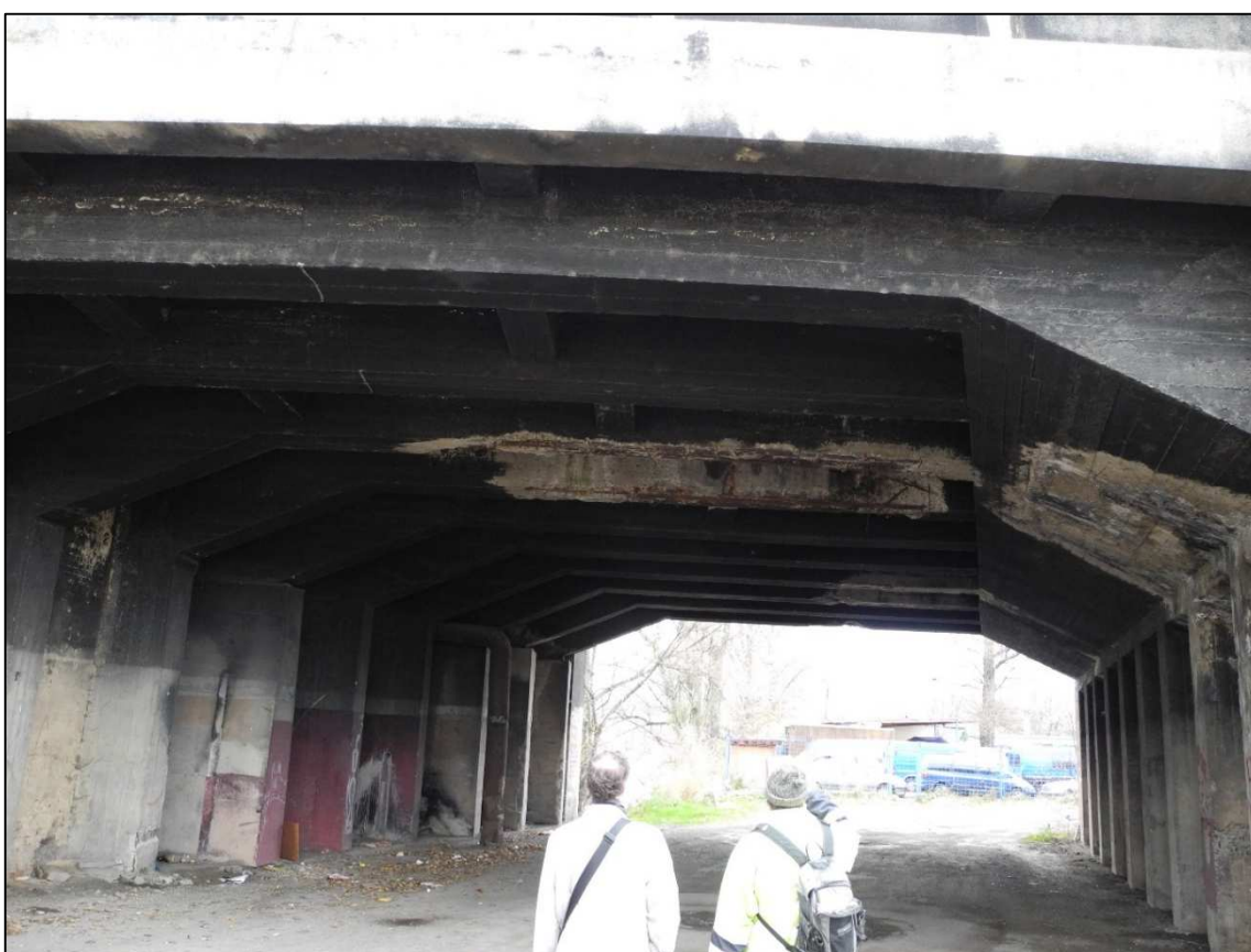
Obr. 39: jižní pohled na rámovou konstrukci na pravém břehu Vltavy (ul. U Libeňského mostu), koroze obnažené výztuže, lokální průsaky a výluhy na černě natřené konstrukci, převážně v místech podélných dilatací
