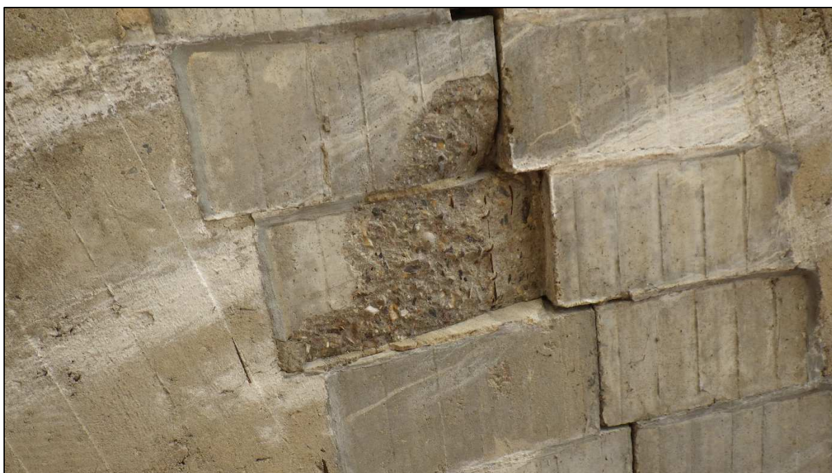
Obr. 14: Pohled na dva odštipnuté bloky beton levého patního kloubu druhého pásu oblouku s odkrytou měkkou výztuží, viditelné výluhy od zatékání
