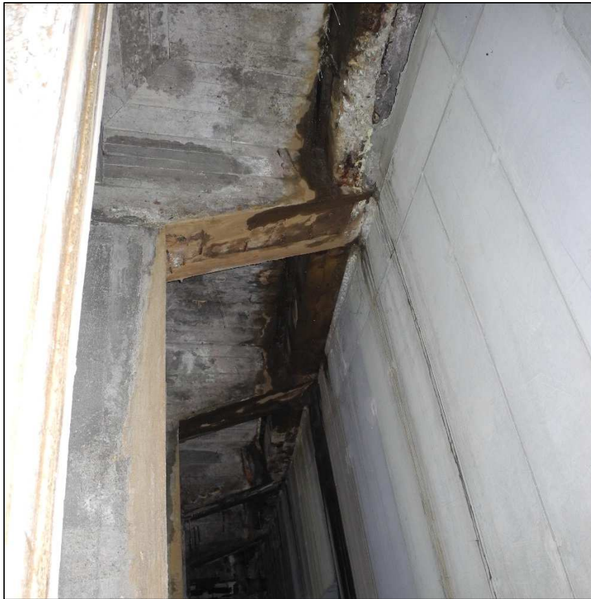
Obr. 34: Pohled na ukončení rámové konstrukce u dilatace na provizorní zdi z roku 2009 okolí kolem dilatace viditelně vlhké vlivem zatékání vody shora
