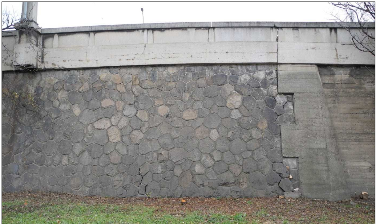
Obr. 35: Severní pohled na stěnu s rozevřenou trhlinou ve spáře kyklopského zdiva, která probíhá po celé výšce konstrukce včetně žb. zábradlí
