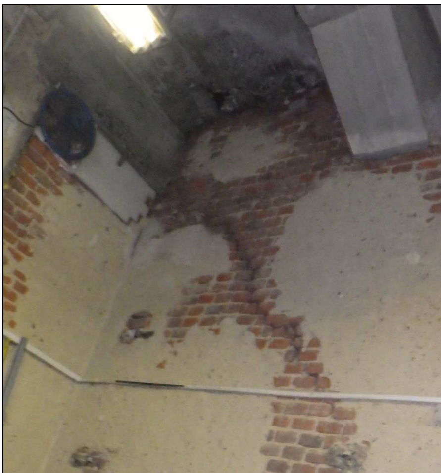
Obr. 28: Pohled na průběžnou trhlinu ve zdivu v objektu společnosti Most servis, tj. uzavřená rámová konstrukce vedle oblouku směrem k Holešovicím
