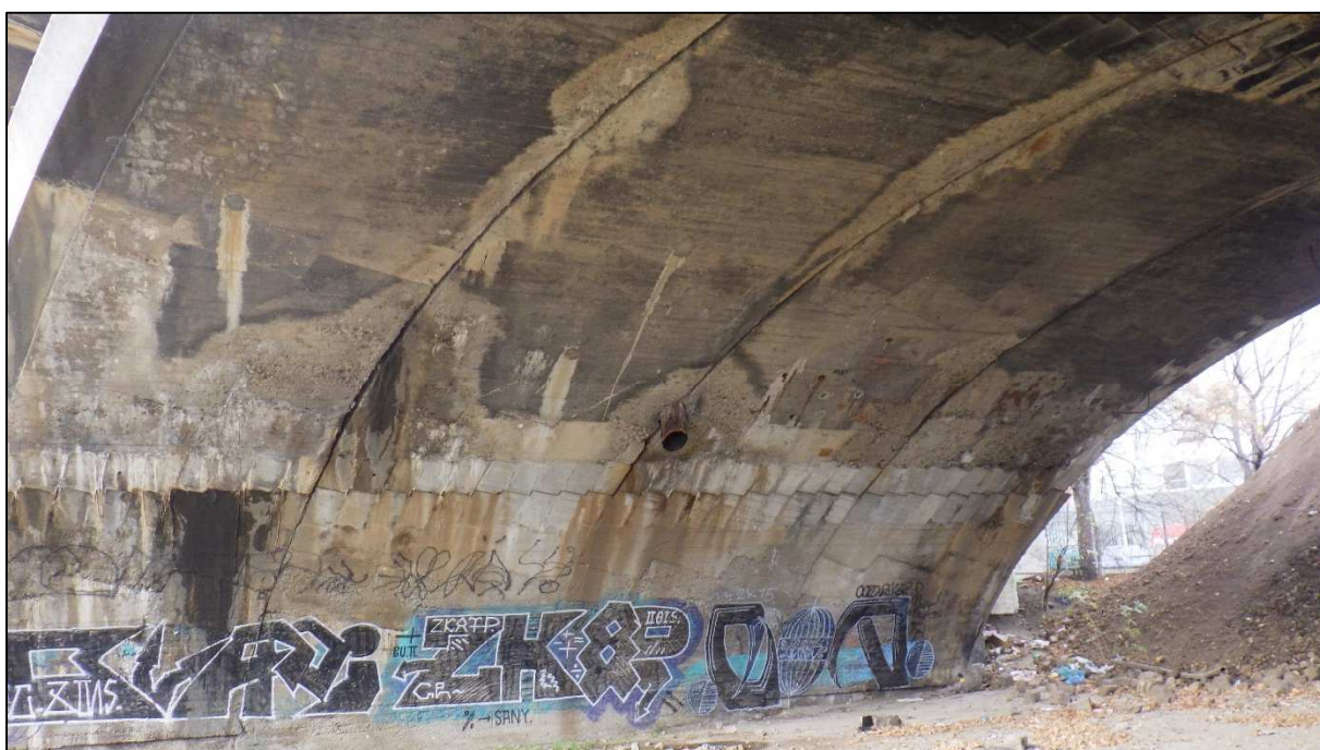
Obr. 8: Pohled na pásy prvního oblouku včetně vývodu odvodnění povrchové vody z mostovky, na třetím a čtvrtém pásu oblouku nad patním kloubem provedeny jádrové vývrty pro kontrolu pokusu o sanaci - zpevnění betonu pomocí tlakové injektáže
