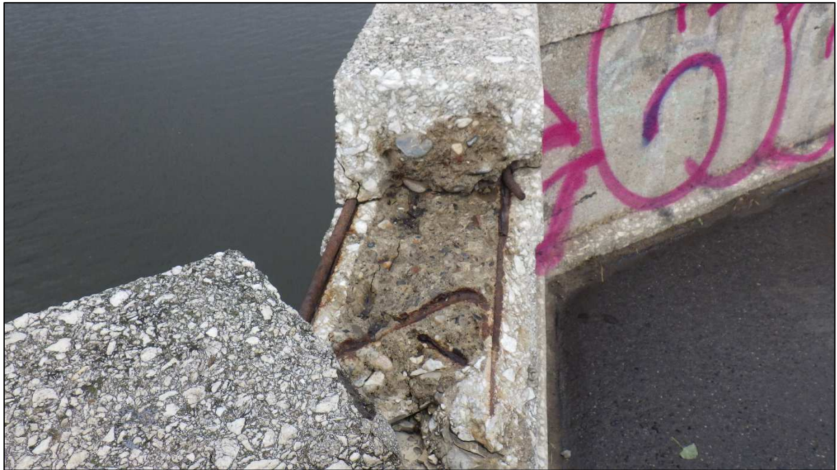
Obr. 18: Detail odpadlé části madla zábradlí, vodorovná výztuž u vnější strany (směrem od chodníku) v předsazené vrstvě betonu, viditelně rozdílná nasákavost jádra a povrchové předsazené vrstvy
