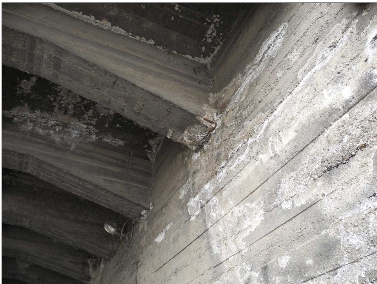
Obr. 36: Detailní pohled na ukončení rámové konstrukce, prokreslena výztuž průvlaků, výluhy na stěně a na stropu – podjezd na Libeňský ostrov
