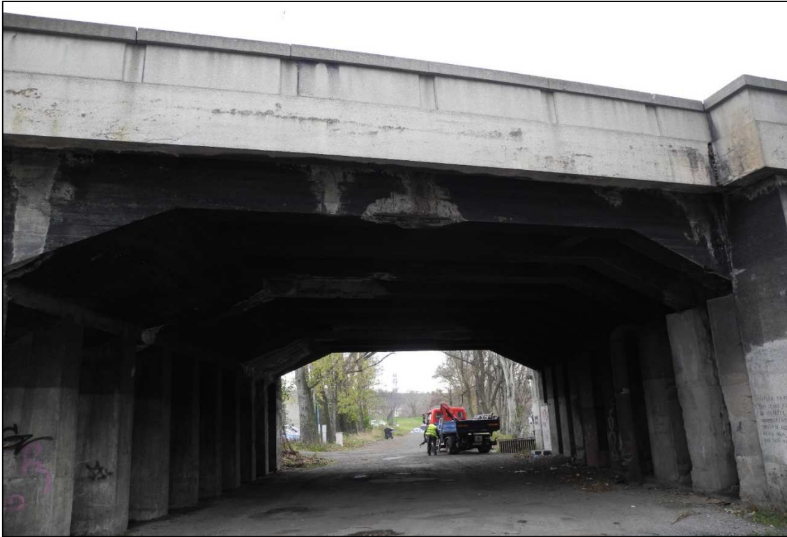
Obr. 41: Severní pohled na rámovou konstrukci na pravém břehu Vltavy (ul. U Libeňského mostu), navazující na 5. oblouk hlavního mostu přes Vltavu, lokální koroze obnažené výztuže, výrazná vodorovná trhlina v římsě pod zábradlím
