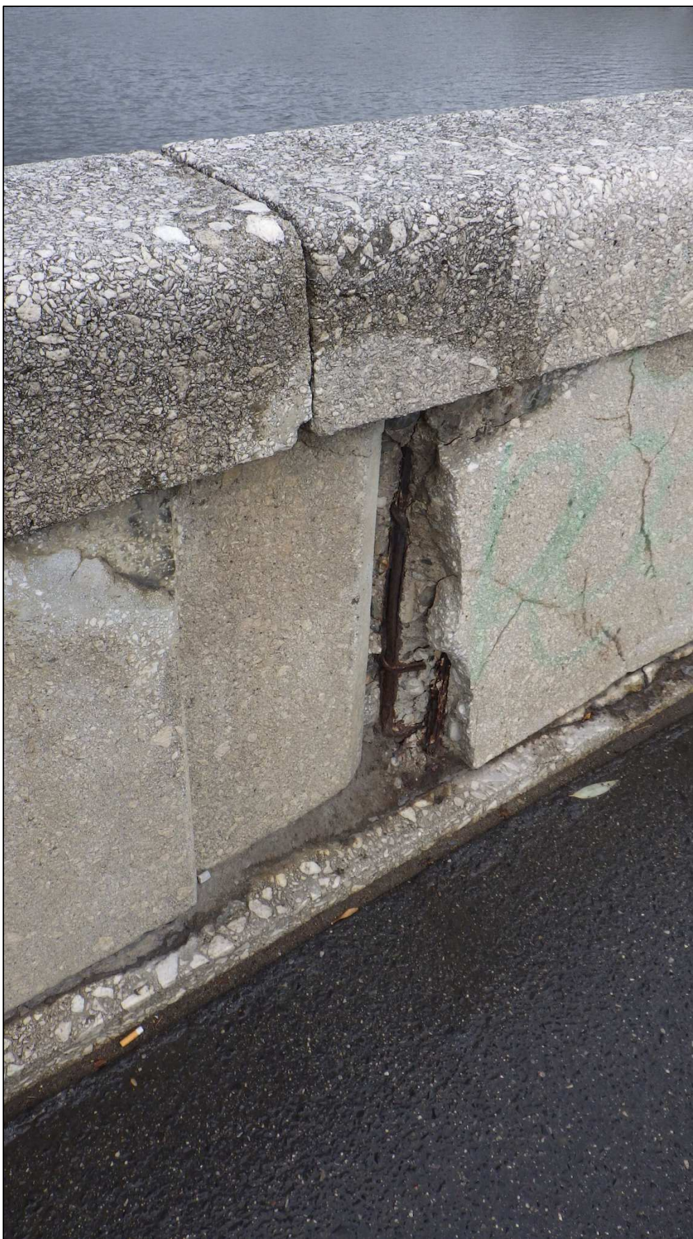
Obr. 17: Odloupnutá krycí vrstva zábradlí s obnaženou výztuží – typický příklad často se opakující poruchy zábradlí
