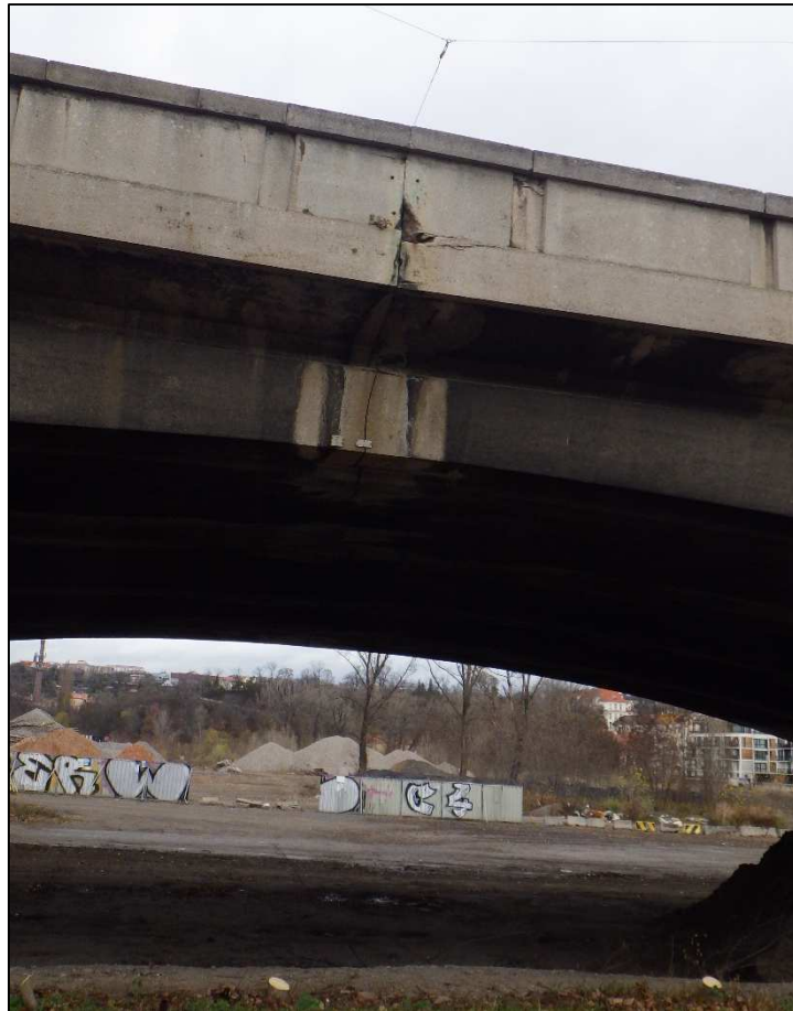
Obr. 26: Širší pohled na předchozí místo s viditelným porušením zábradlí
