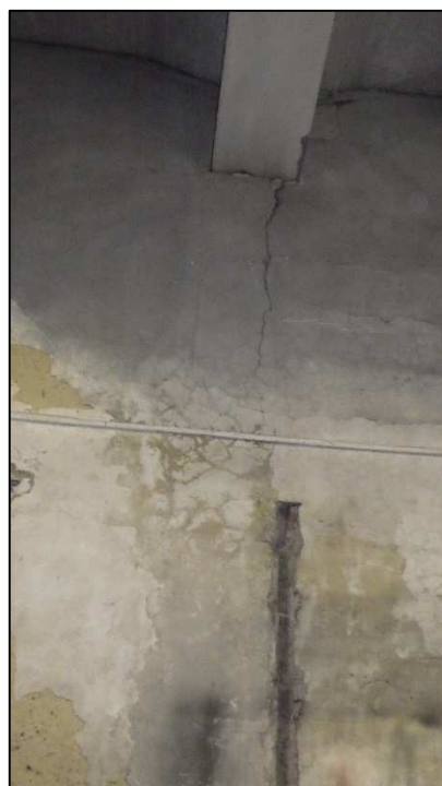
Obr. 29: Prokreslená trhlinka vyzdívky v místě podélného trámu, objektu společnosti Most servis
