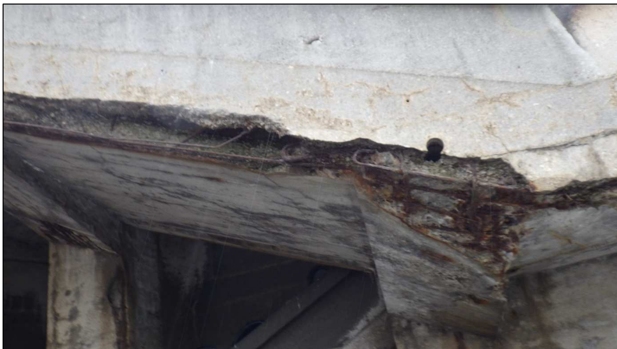
Obr. 15: Odpadlé krycí vrstvy výztuže z konstrukce schodiště u pilíře mezi prvním a druhým obloukem ve směru od Holešovic, dezolátní stav žb. části konstrukce
