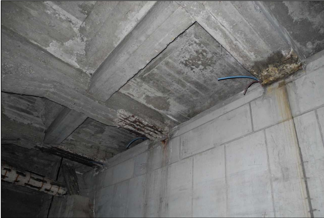
Obr. 32: Koroze výztuže rámových trámů, absence krycí vrstvy výztuže, objekt Most servis, provizorní podchycení konce rámové části z roku 2009
