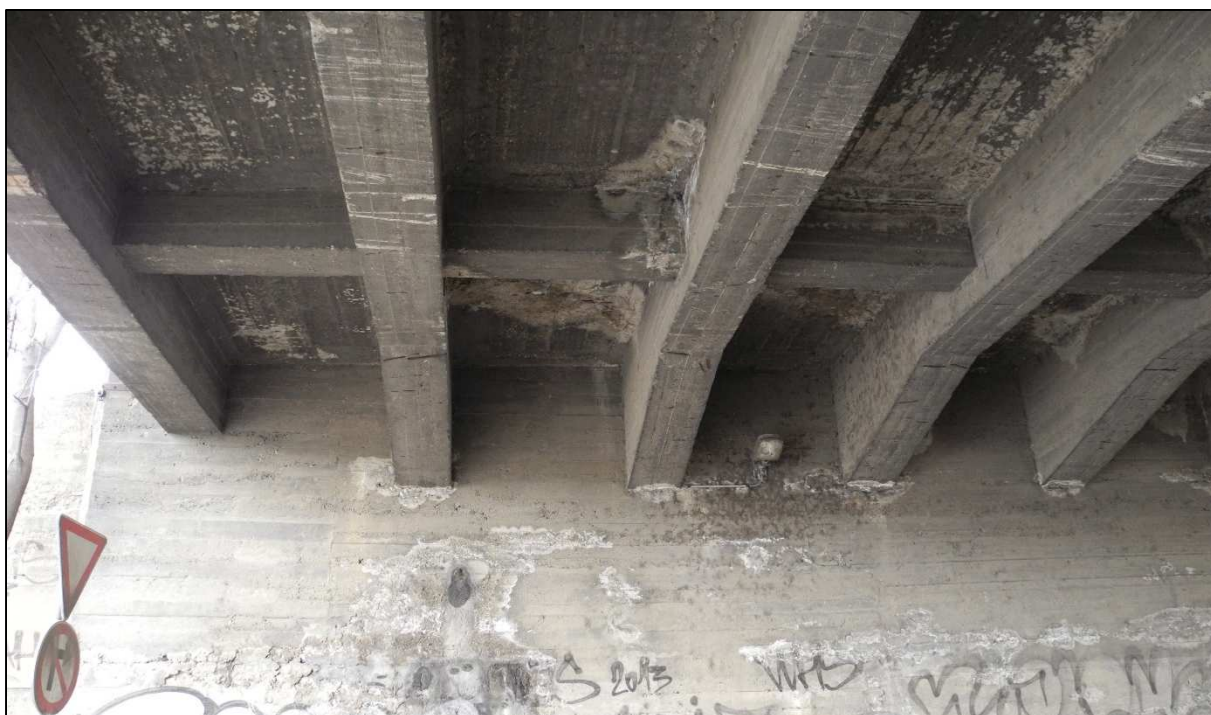
Obr. 37: Pohled na styk vodorovné a svislé konstrukce, lokálně prokreslená výztuž desky v poli, výluhy na spodní straně stropní konstrukce, prokreslena výztuž průvlaků
