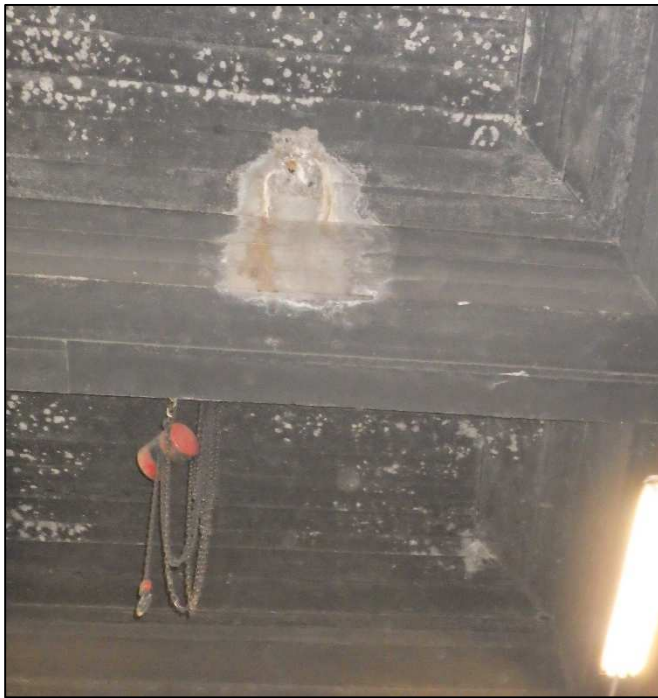
Obr. 30: Výluh na černém podhledu stropu v objektu společnosti Most servis, v místě lokální poruchy/ prostupu?
