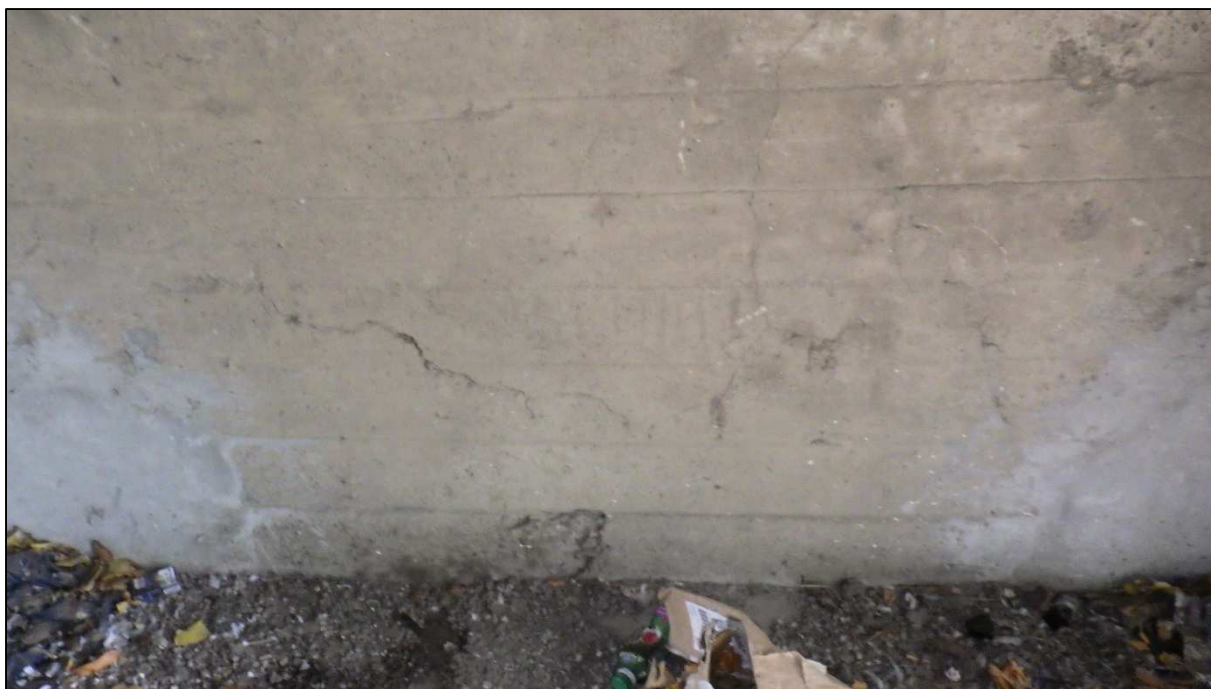
Obr. 5: Viditelné trhliny v betonu v pracovních spárách – stěna společné opěry rámu a prvního oblouku na holešovickém břehu
