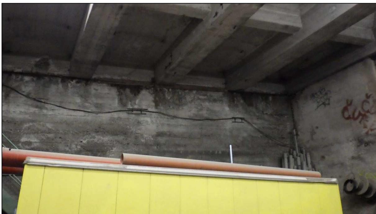
Obr. 23: Pohled na příčnou podporu rámové konstrukce - interiér viz Obr.22, patrné zatékání příčnou spárkou shora
