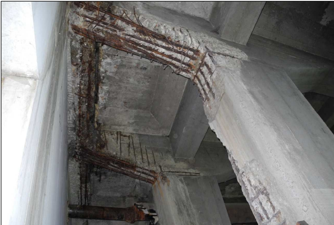
Obr. 33: Detailní pohled na korozi výztuže rámové konstrukce, absence krycí vrstvy na vodorovné i na svislé části nosné konstrukce
