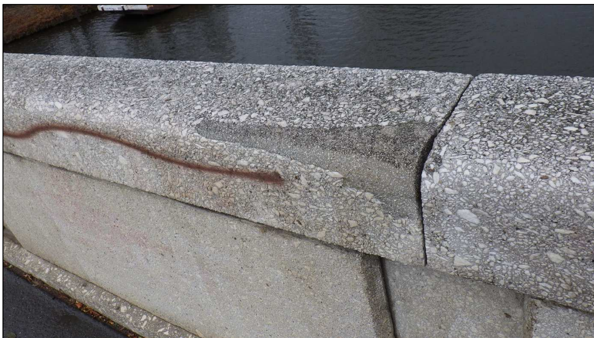
Obr. 20: V minulosti sanovaná část madla zábradlí, pravděpodobně již brzy po realizaci mostu
