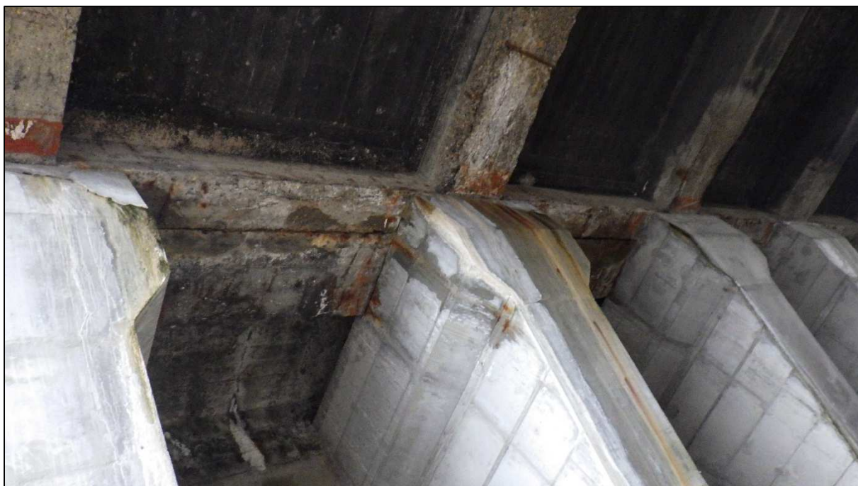
Obr. 3: Detailní pohled na první provizorně podepřený kloub (1.pole přes vlečku), stopy zatékání viditelná vyšší vlhkost.
