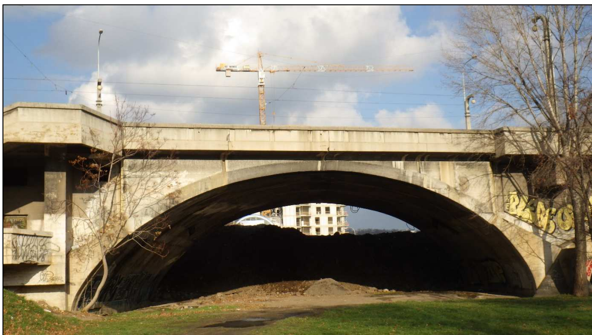
Obr. 6: Jižní pohled na první oblouk Libeňského mostu – Holešovice – oba pilíře oblouku založeny na břehu Vltavy; viditelný pokles středního kloubu a římsy nad ním, stopy průsaků na podélných dilatačních spárách
