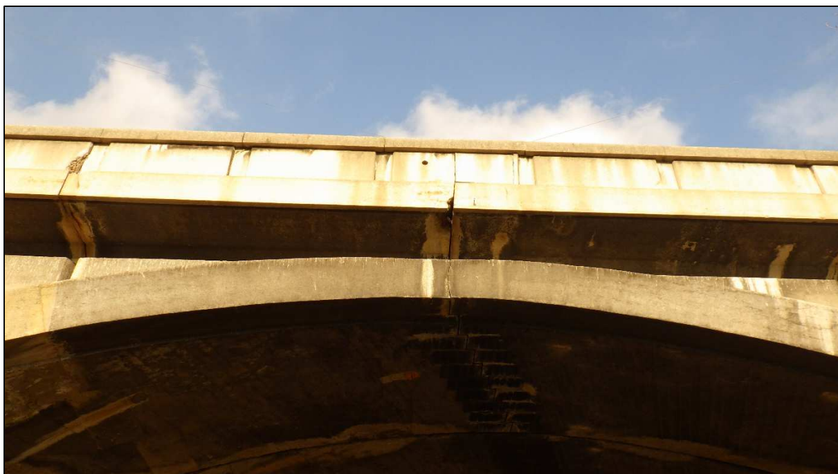
Obr. 7: Detail vrcholového kloubu prvního oblouku; na spodní hraně římsy patrné odrcení betonu, v místě části římsy/zábradlí překračující vrcholový kloub zřetelná svislá trhlinka sahající až pod „madlo zábradlí“, zřetelné stopy průsaků s výluhy na všech spárách
