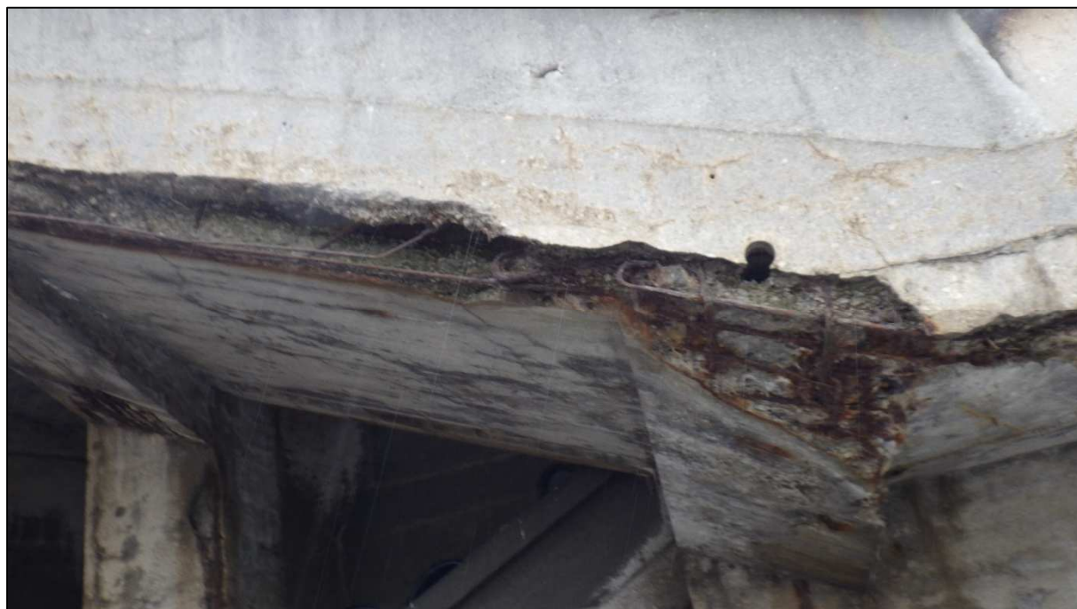
Obr. 15 Stav konstrukce v roce 2015. Progresivně zhoršující se stav. Silná degradace konstrukce.
