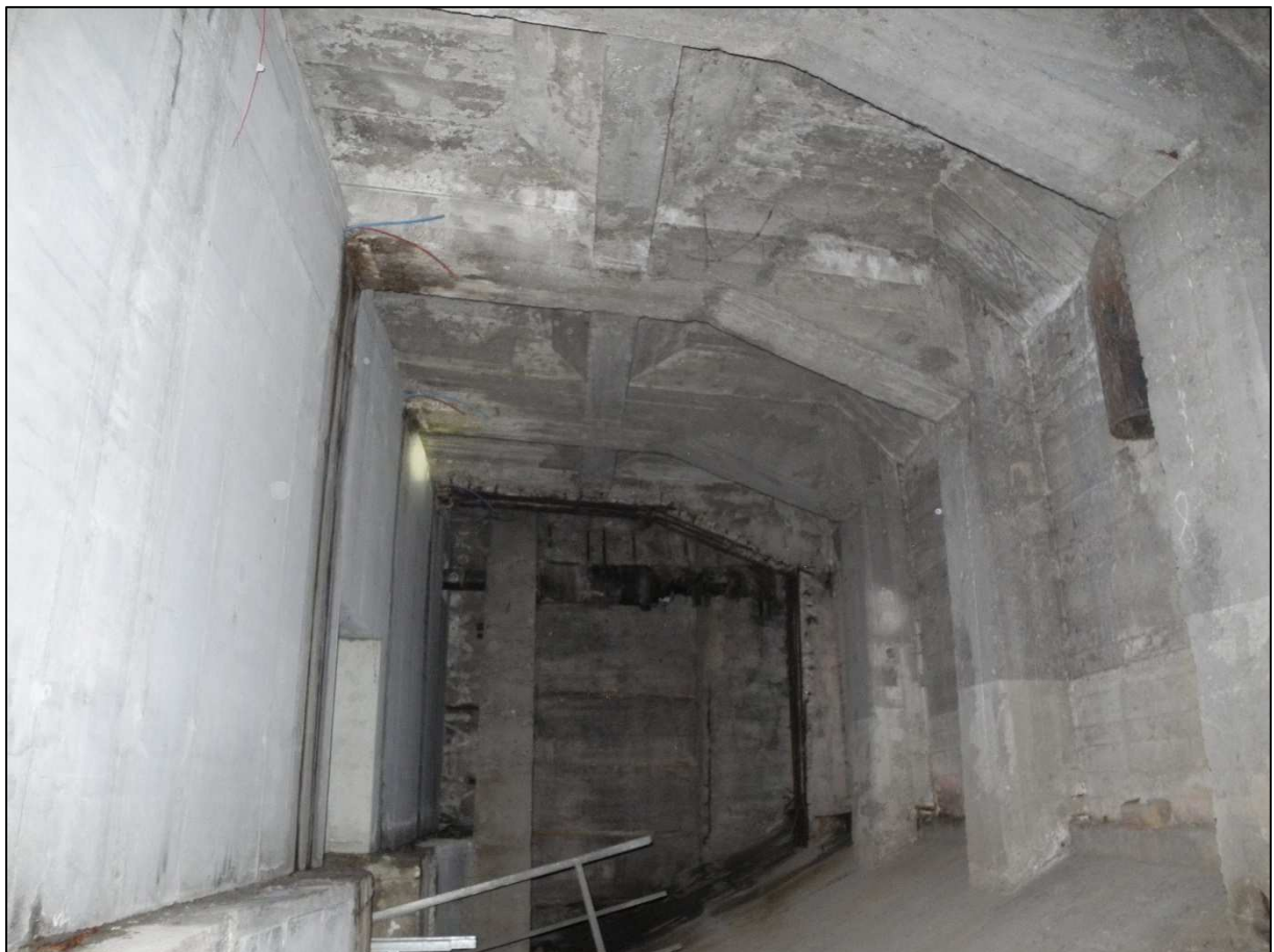
Obr. 31: Pohled na rámovou konstrukci v objektu společnosti Most servis, v zadní části prostoru nad patou oblouku, lokální stopy zatékání a návazné degradace, příčná stěna nad patním kloubem oblouku
