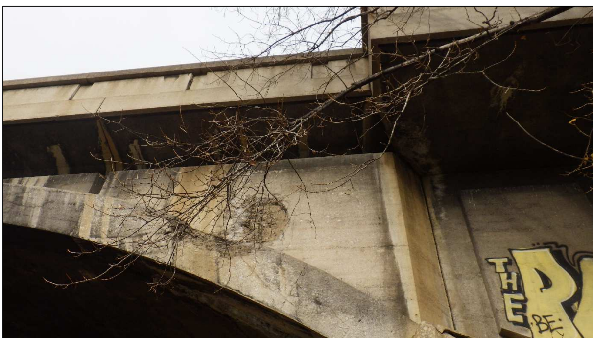
Obr. 10: Pohled na pravou stranu prvního oblouku od jihu s viditelným výrazným poškozením krycí vrstvy betonu oblouku i podélné stěny nad ním
