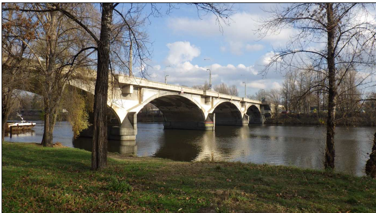
Obr. 16: Jižní pohled na část obloukové konstrukce Libeňského mostu přes Vltavu z holešovického břehu – dobře viditelná úroveň max. hladiny při povodni 2002
