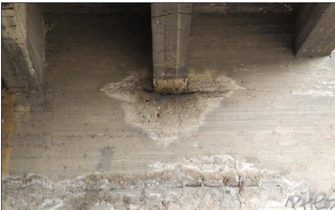
Obr. 38: porucha s průsakem v místě pracovní spáry stěny
