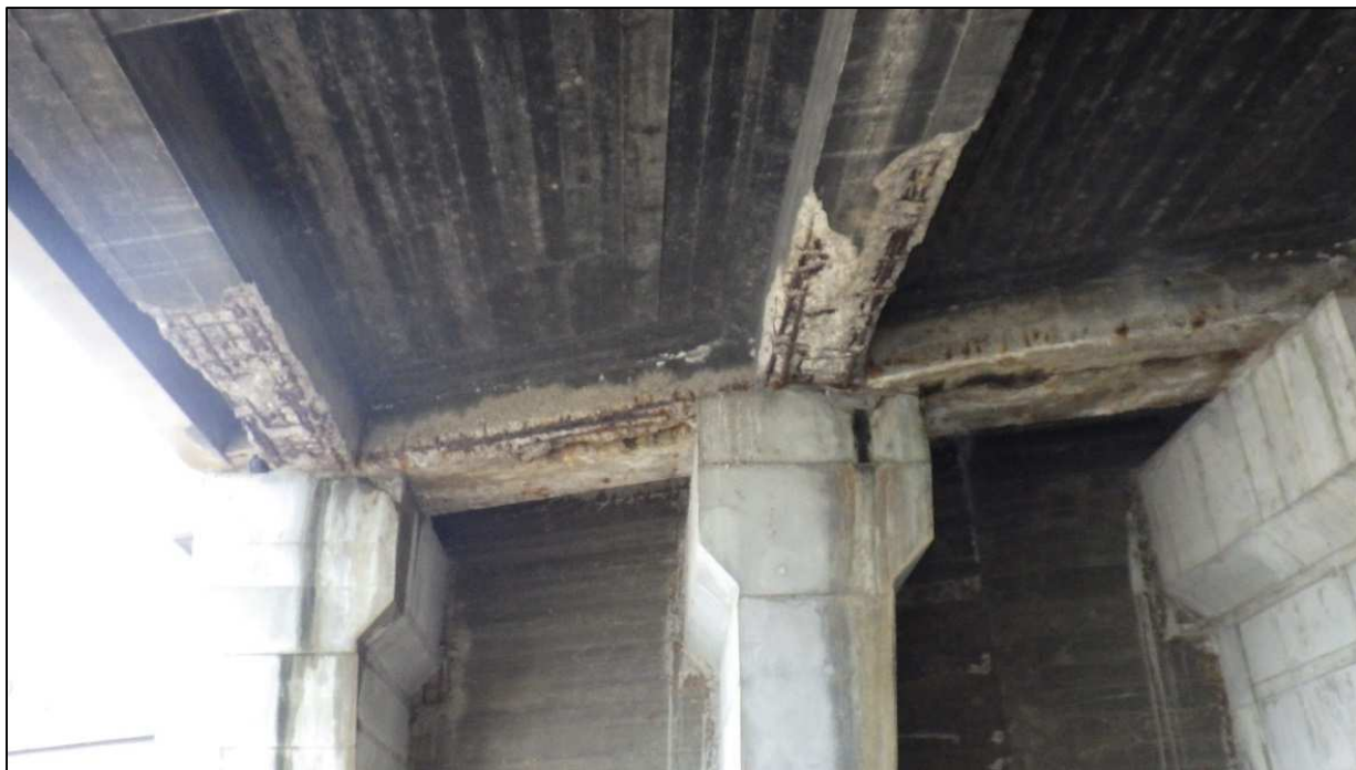
Obr. 13 Stav konstrukce v roce 2015. Doplněná zajišťovací podpůrná konstrukce a pokračující silná degradace. Výrazné zhoršení stavu.
