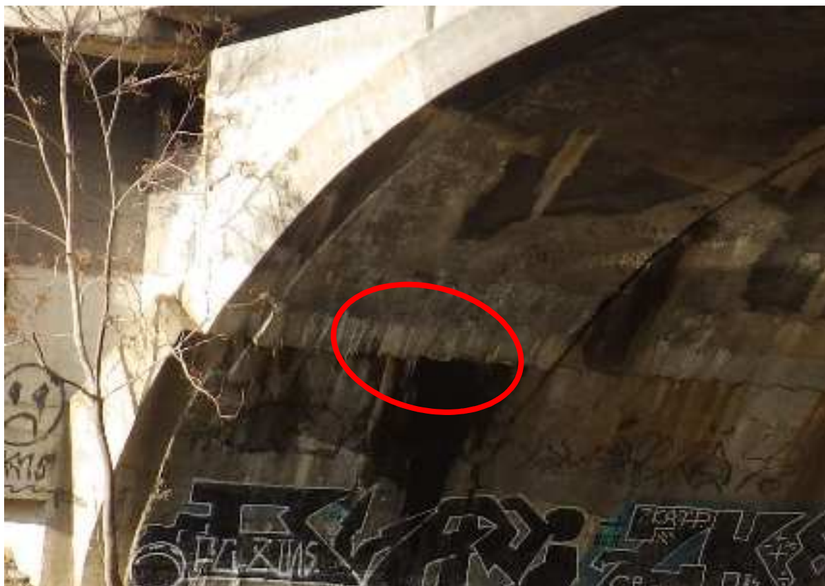
Obr. 17 Stav konstrukce v roce 2015. Pokračující průsaky a degradace betonu oblouků
