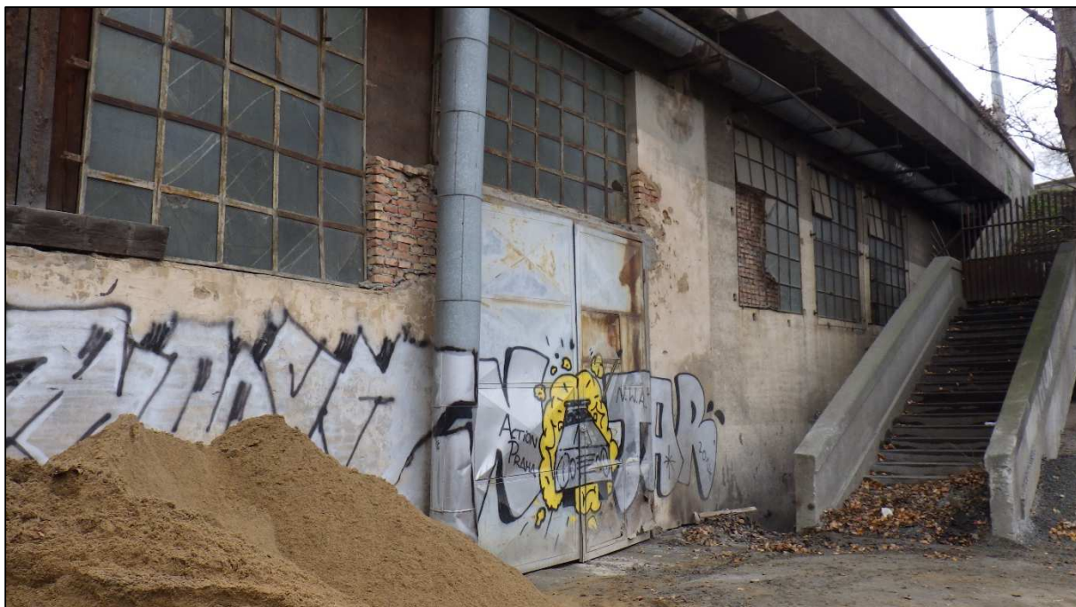
Obr. 22: Severní pohled na stěnu objektu vzniklého uzavřením rámových konstrukcí na pravém břehu Vltavy – část Libeň, zkroucený rám ocelových vrat, trhliny v meziokenním pilíři, patrně důsledky změn podloží po povodni 2002, vpravo uzavřené schodiště
