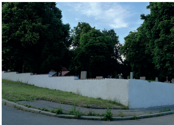
026 Klasické řešení zdi na svažitém pozemku – pravidelné odstupňování se vhodně uplatní i v případě hřbitovů [ Praha 13, Stodůlecký hřbitov ]
