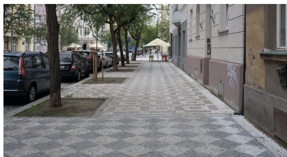
Jednou z charakteristik pražské mozaikové dlažby je, že se před jednotlivými domy vzory střídají (Jaselská).
